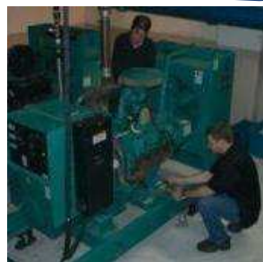
NG Gensets 170 KW
